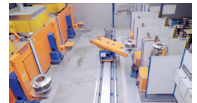
Bild 1: Herzstück der komplexen Anlage ist das intelligente Shuttlesystem, welches die einzelnen Stationen miteinander verbindet.
